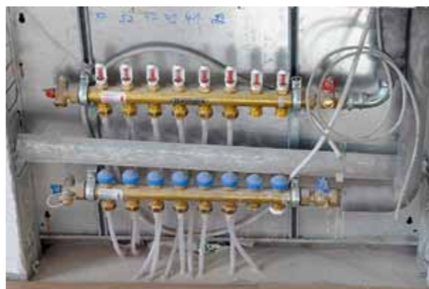
Der Heizkreisverteiler beliefert fast ausschließlich Fußbodenheizungskreise
