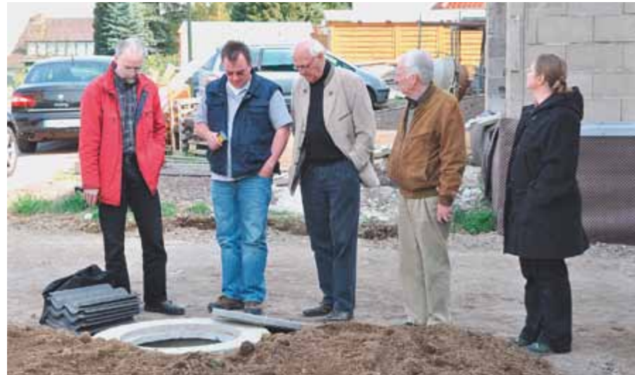
Der ebenerdig vergrabene Eisspeicher nahm Bauherrn Wilfried Marschinke vor allem die Sorge, bei alternativen Erdwärmehohrungen eventuell auf Fels zu stoßen und dann auf den Kosten sitzen zu bleiben
