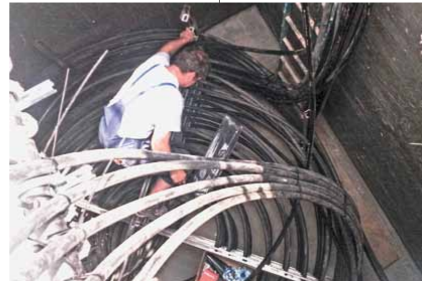
Tauscherinstallation im Energie- oder Kältespeicher. Später wird er mit etwa 25 m 3 Wasser gefüllt sein
