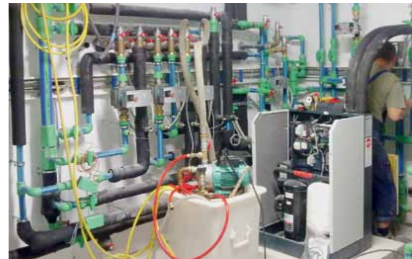
Anschluss der an die verschiedenen Energiequellen
