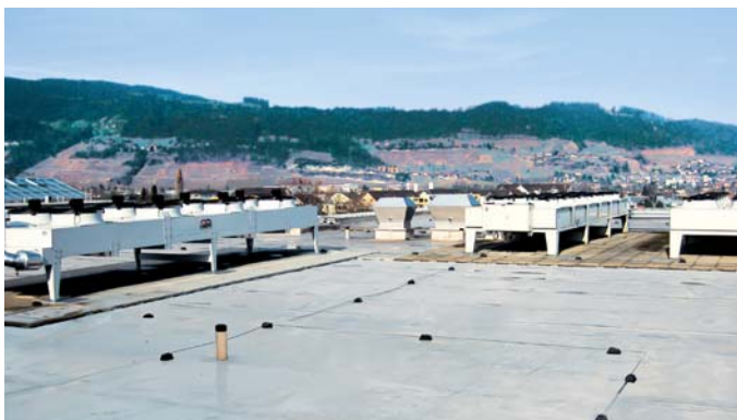
Glykol-Trockenkühler einer Luft/Wasser-Wärmepumpe
