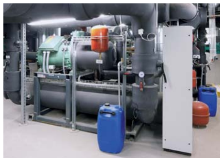
Die drei Großwärmepumpen haben jeweils eine Heizleistung von 1060 kW, eine Kälteleistung von 1050 kW und eine Warmwasserleistung von 155 kW.
