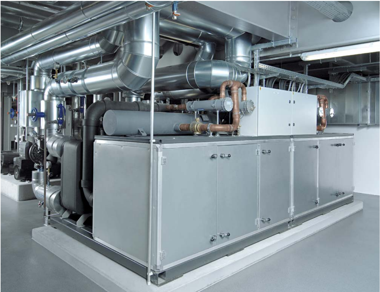
Diese Wärmepumpe nutzt die Abwärme und kühlt gleichzeitig das Rechenzentrum sowie die Geräteprüfstände am Viessmann Standort Allendorf
