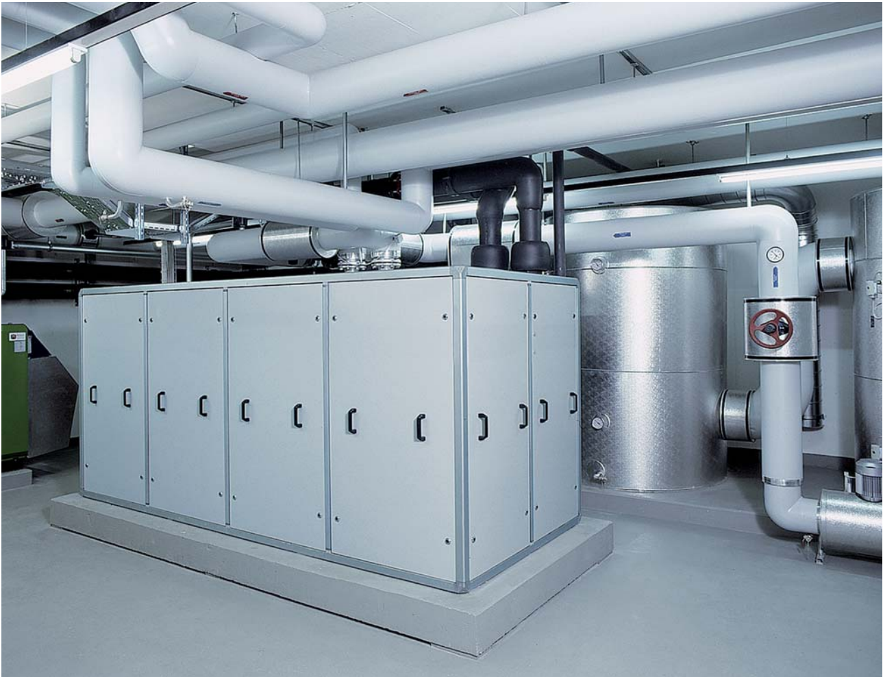
Sole/Wasser-Wärmepumpe mit einer Heizleistung von 290 kW
