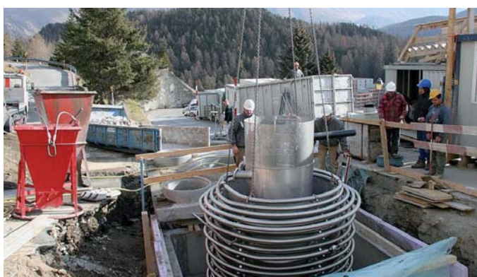
Dieser Abwasserschacht dient als Primärquelle zur Warmwasseraufbereitung.
