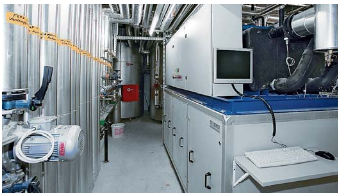
Diese Abwasser-Wärmepumpe mit 150 kW Leistung wird zur Trinkwassererwärmung genutzt.
