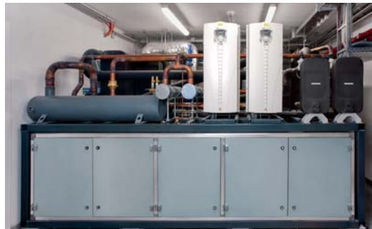
Die Viessmann Großwärmepumpe hat eine Leistung von 360 kW zum Heizen und 438 kW zum Kühlen.
