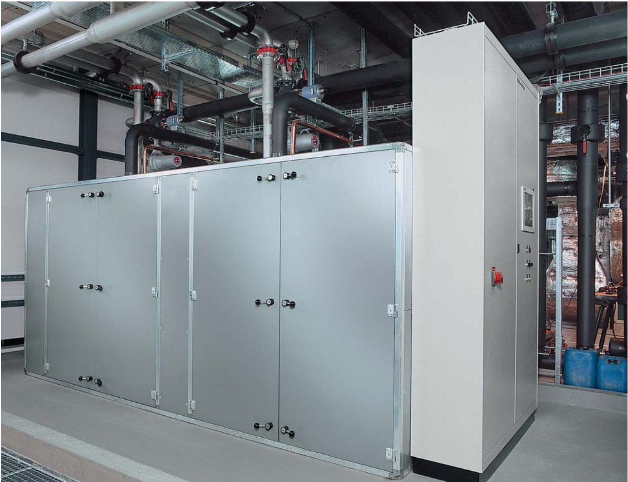
Wasser/Wasser-Wärmepumpe mit einer Heizleistung von 500 kW
